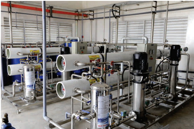
Hệ thống nước RO
