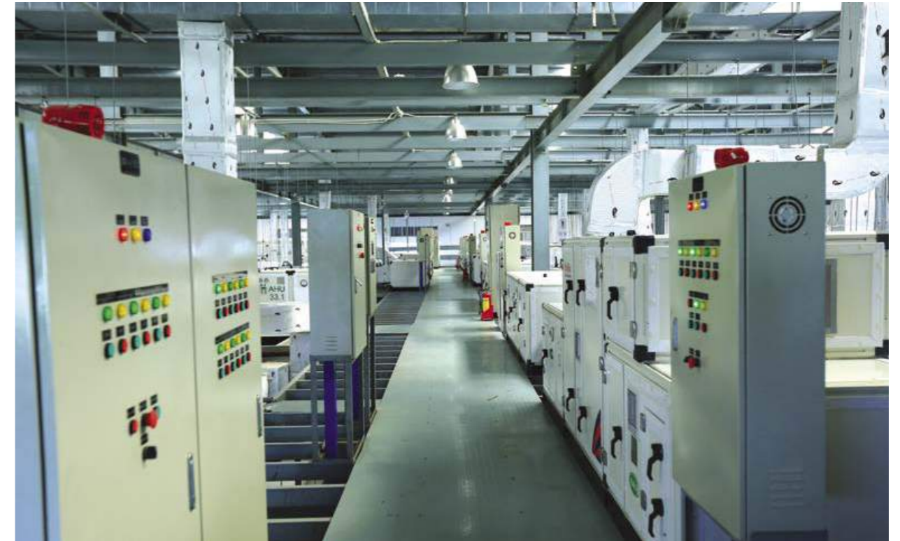
Hệ thống tầng kỹ thuật tại nhà máy mới Non-Betalactam DHG Pharma
